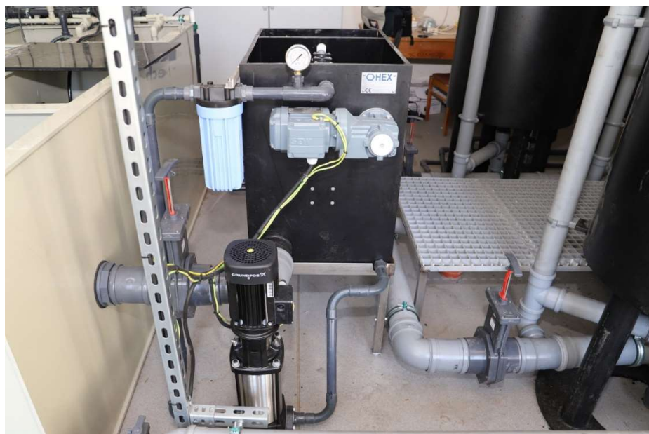
Fot. 12. Filtr mechaniczny typu mikrosito z widoczną pompą płuczącą.
