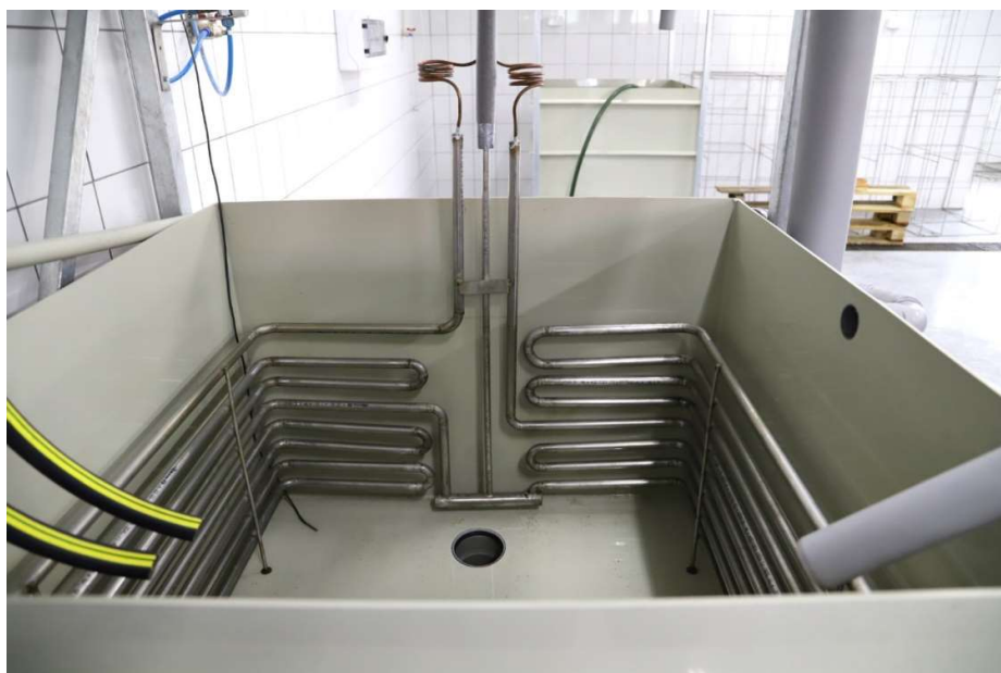
Fot. 14. Wymiennik ciepła recyrkulacyjnego systemu akwakulturowego do inkubacji ikry i podnoszenia wylęgu szczupaka zainstalowana w dolnym zbiorniku retencyjnym (Zakład Rybacki Janowo, Okręg Mazowiecki PZW w Warszawie).
