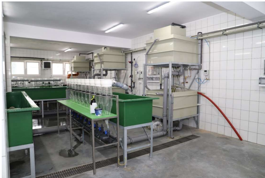
Fot. 1. Recyrkulacyjne systemy akwakulturowe do inkubacji ikry i podnoszenia wylęgu szczupaka – widok ogólny (Zakład Rybacki Janowo, Okręg Mazowiecki PZW w Warszawie).
